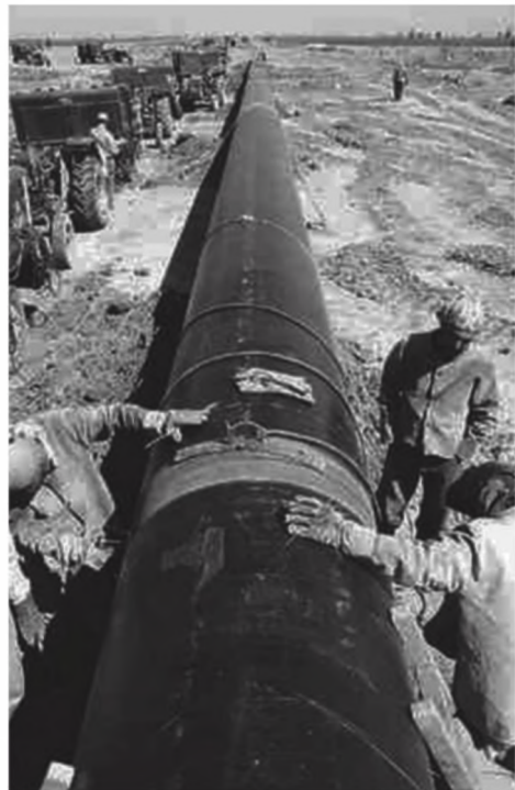
連接哈薩克斯坦和中國的石油輸送管道
