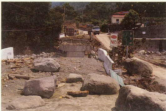
■ 筆石橋可歸為土石流高漲、無法排放的致命傷，導致9戶27人死亡。
