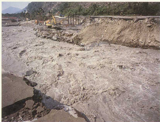
■ 陳有蘭溪橋被土石流完全刮除。
