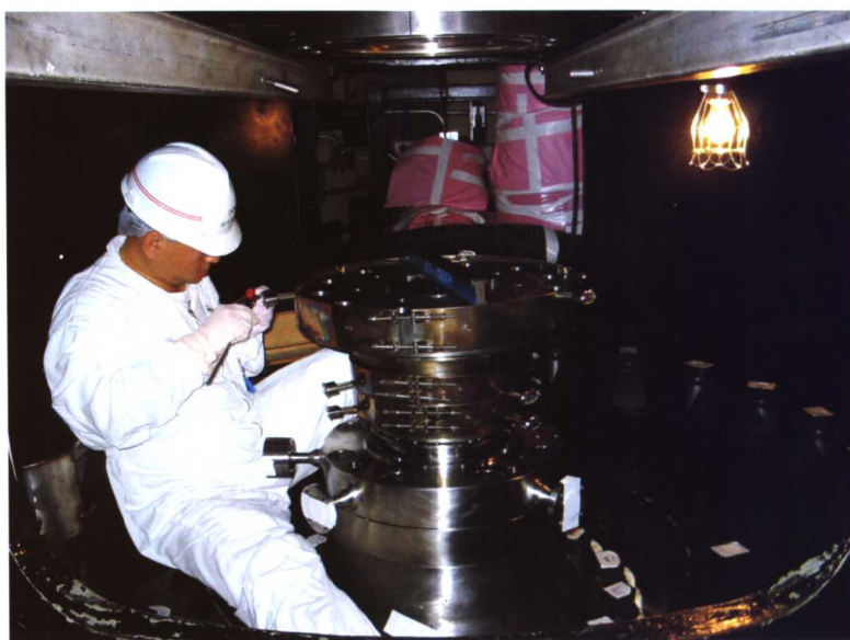
一回路主泵大修检查
