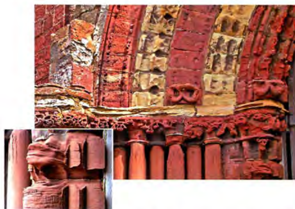
图13.11 化学风化对教堂砂岩建筑材料的破坏 注：在苏格兰Kirkwell，圣玛格纳斯大教堂的西侧入口，石材中的胶结物质受到化学风化破坏后留下的痕迹。这座大型建筑建于公元1137年。[Bobbé Christopherson]
