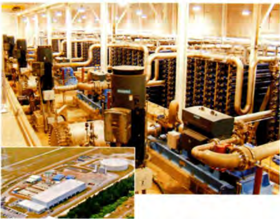
(b) 坦帕湾的海水淡化工厂利用过滤和反渗透过程向当地每天提供25MGD的淡水
