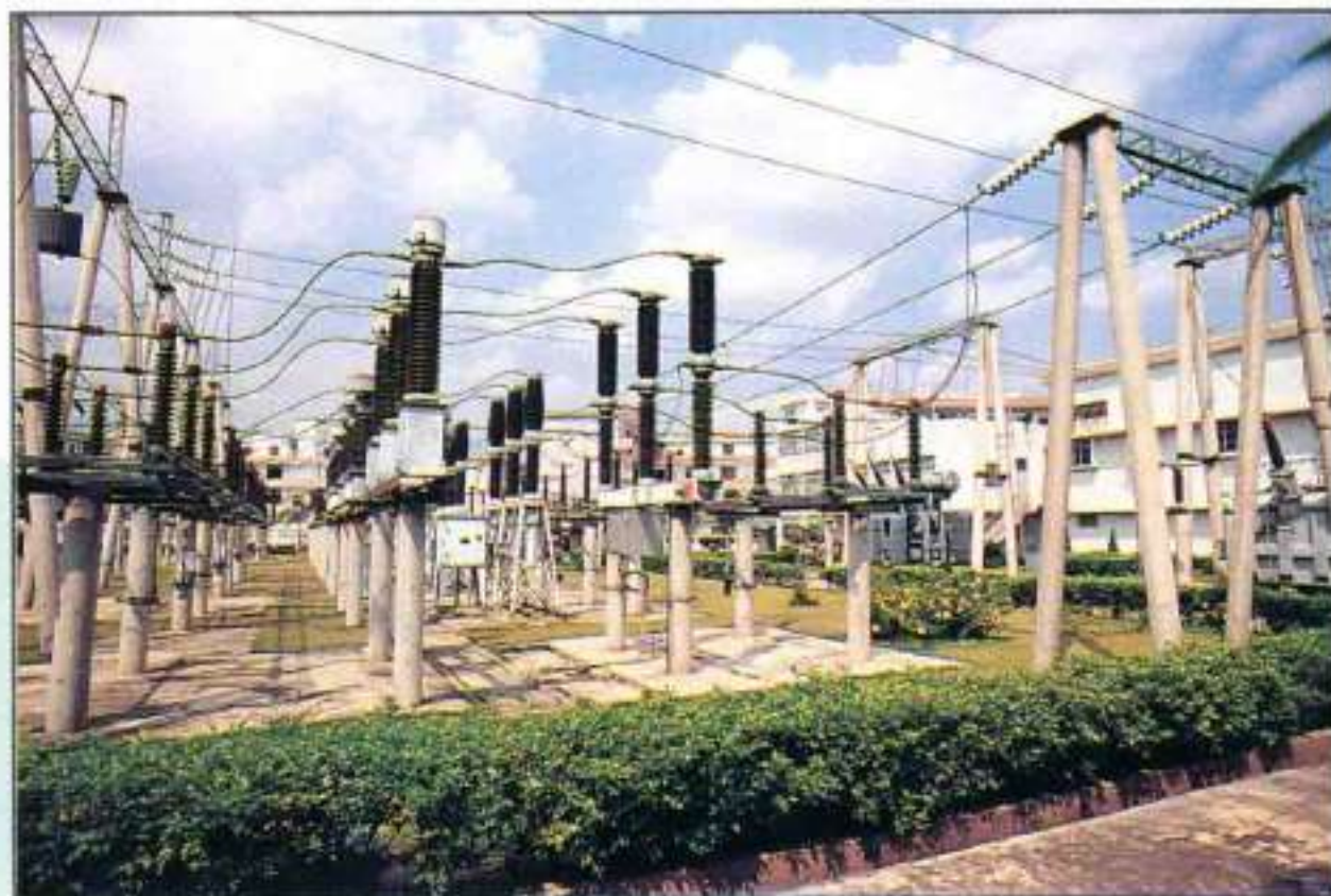
十一萬伏變電站
