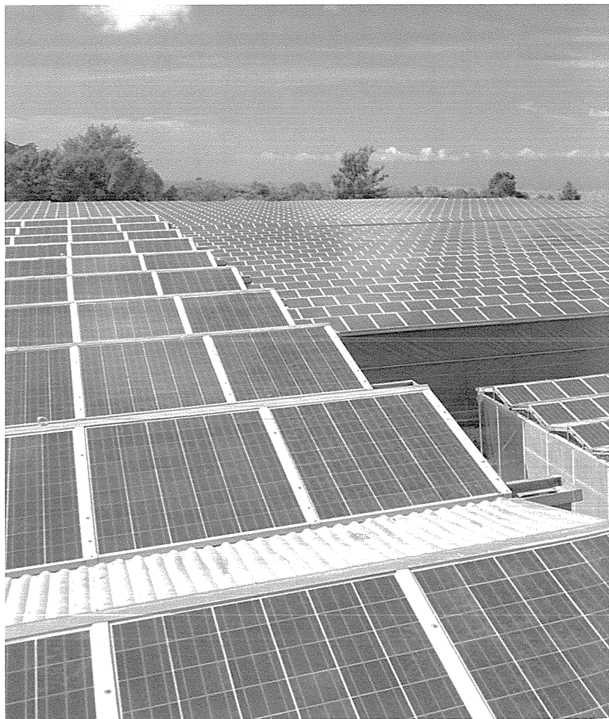
靠近坦朋（Tampon）的這些溫室負責供應五百一十五家戶的用電。
