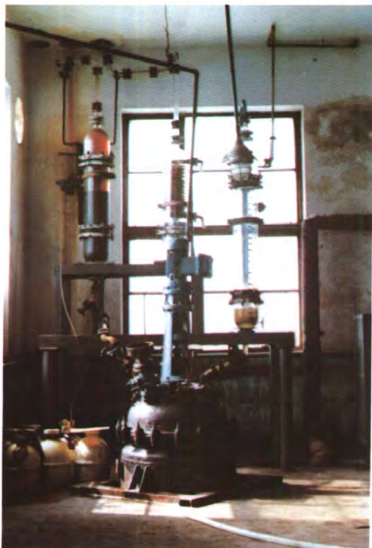
20 山东省莱州盐场 TBC 阻燃剂车间 (山东省盐业公司供稿)
