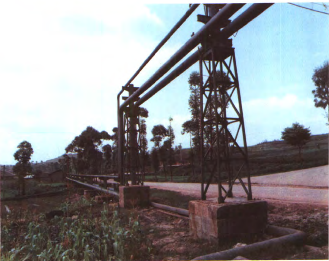
15 四川省自贡市长山盐矿油垫井井口装置和管汇(上图) 四川省自贡市长山盐矿输卤管道(下图) (自贡市盐业史博物馆谢奇筹摄影)
