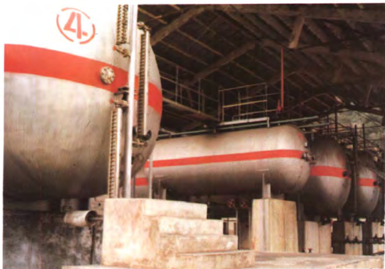
21 湖南省湘澧盐矿芒硝车间钛氨蒸发器 (湖南省盐业公司供稿)
