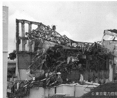
爆炸後3號機反應爐廠房的外觀，爆炸的威力使得大型瓦礫四處散落。（攝於2011年3月15日）
