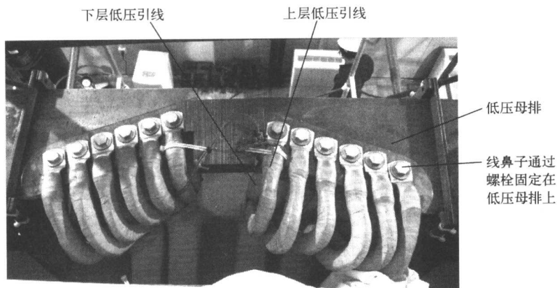
图5 低压绕组引线线鼻子布置图（3号主变压器更换线鼻子前）
