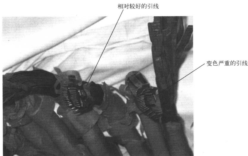
图 14 剖开线鼻子的低压引线端部
