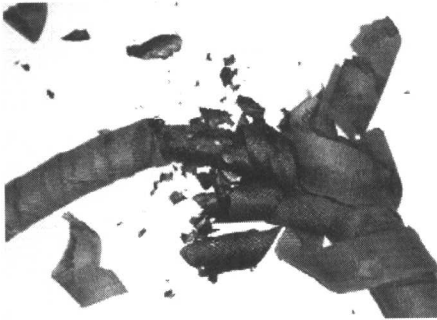
图6 烧毁的横梁与过梁间等电位线
