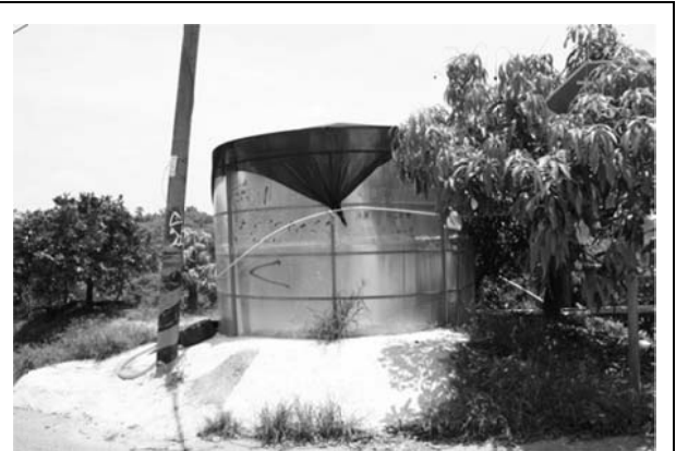
圖 四-28 專案補助的貯存槽 說明：研究者於民國九十九年六月六日拍攝於荊子埔。約有一般水塔的 4 倍大，上方還有補助字樣。
