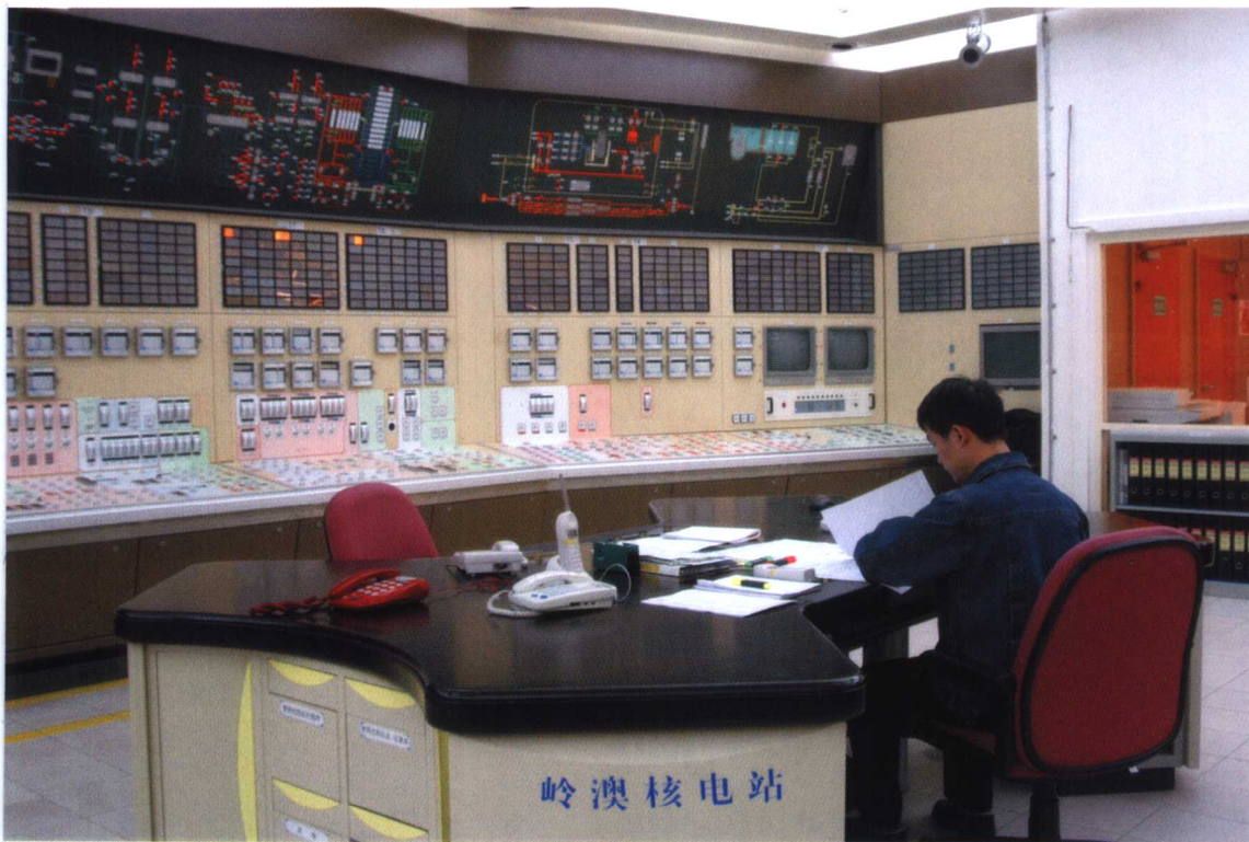
■ 岭澳核电站主控制室
