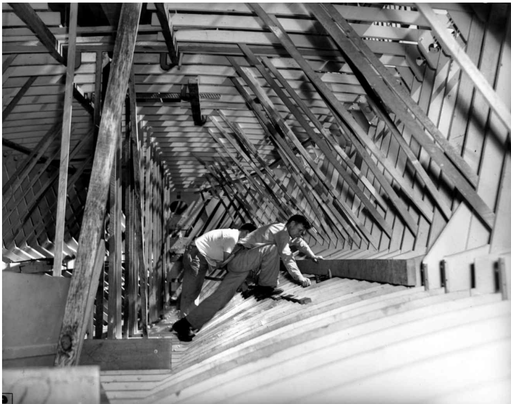
图11 美国海军在第二次世界大战时用木材建造高速摩托动力的鱼雷艇。他们是在工作棚下用预铸的材
