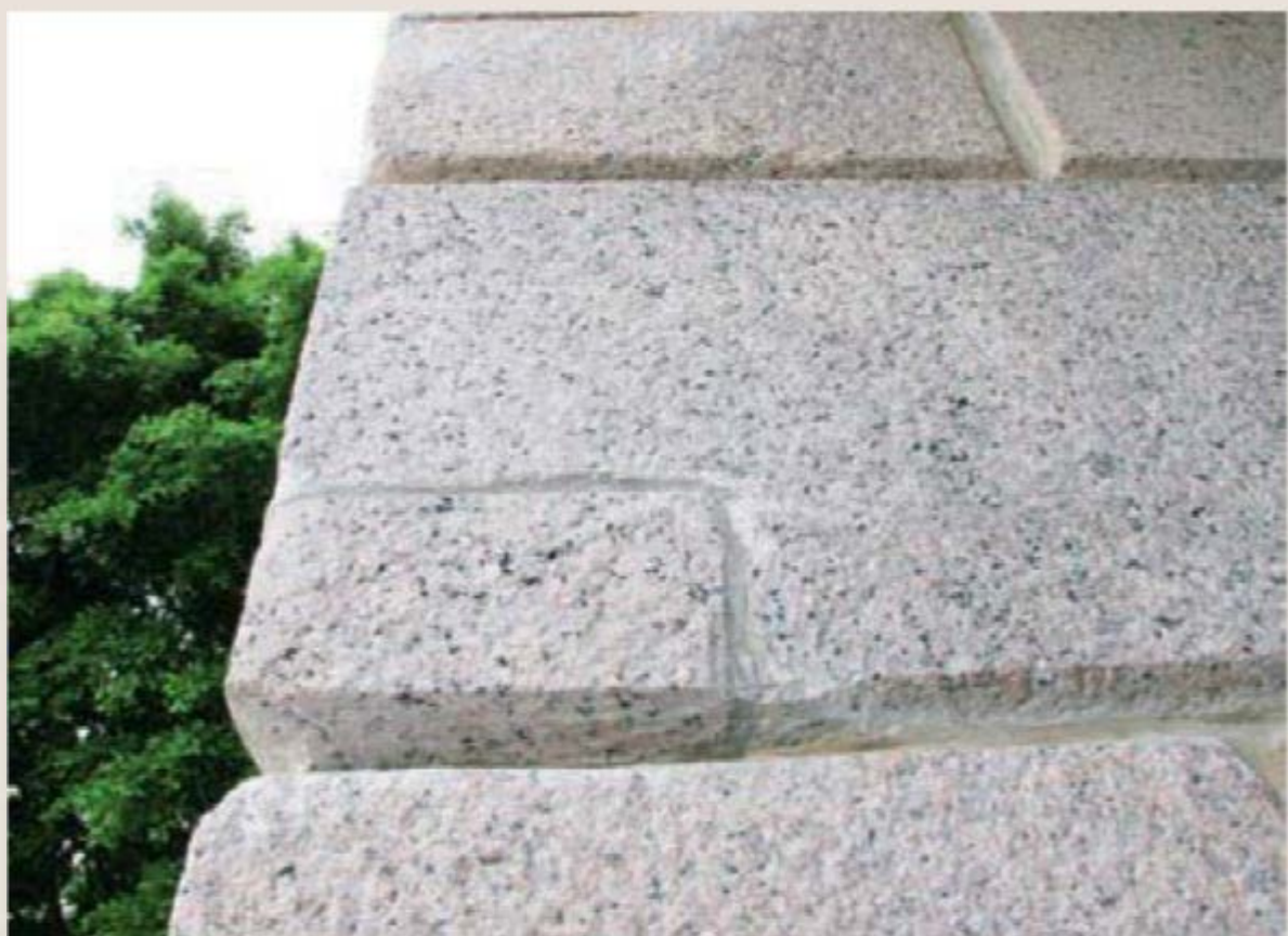
近看美利樓，還可發現一些修補的地方，和當年寫上的記號
