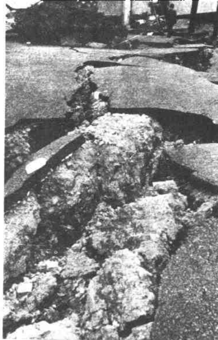
七级地震使松软的公路出现了很大的裂缝。摄于伊豆半岛河津镇
