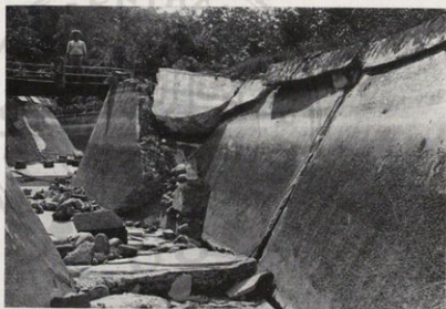
后里圳路の崩壊
