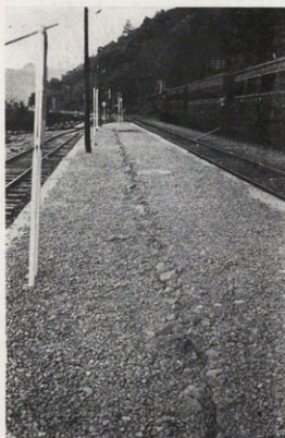
大安驛ホムム線の龜裂
