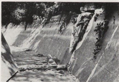
后里圳路の崩壊
