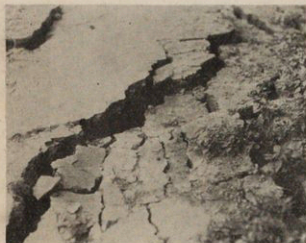
屯子脚の大龜裂
