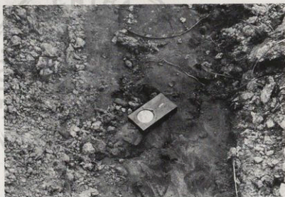
石圍庄九房層の龜裂よ り地下水を噴出す
